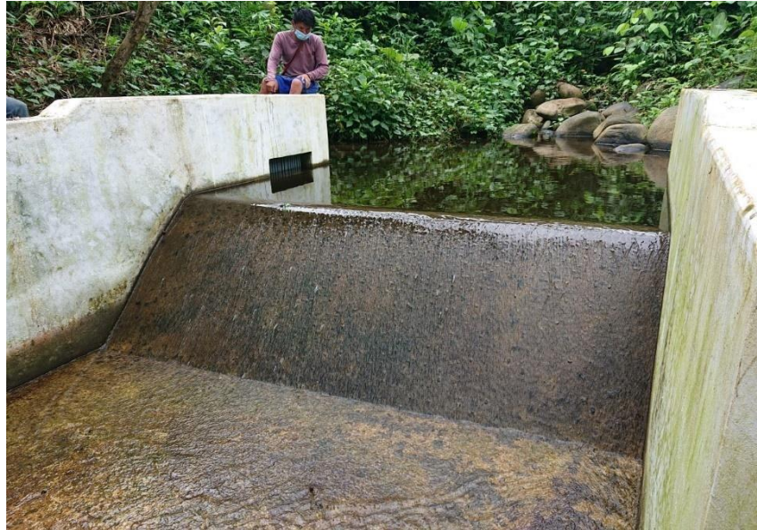
Figura 158: Captación de agua de la quebrada Sagontuari
