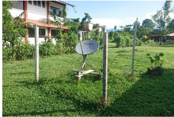
Figura 167: SERVICIO DE TELECOMUNICACIONES - INTERNET
