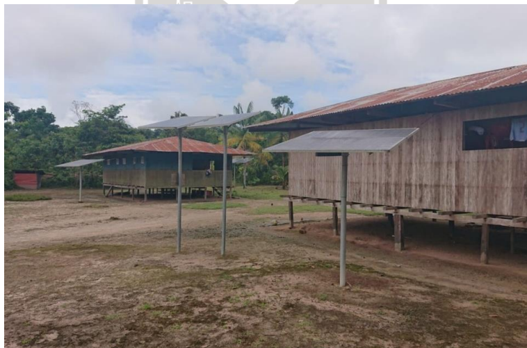
Figura 165: Paneles solares empleados en la comunidad de Kochiri
